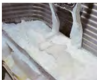
Oblodzenie urządzenia zewnętrznego bez ogrzewania tacy
